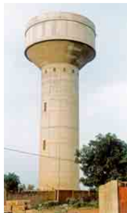
Serbatoio d'acqua alimentato dall'acqua delle dighe
